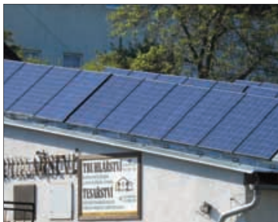
Fotovoltaické panely, Lánov
