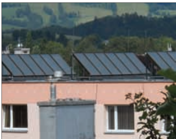
Solární kolektory, Liščí kopec, Vrchlabí
